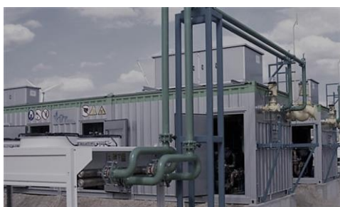
[Bild 2 Biogas – Kompressoren Turn Key Container]
